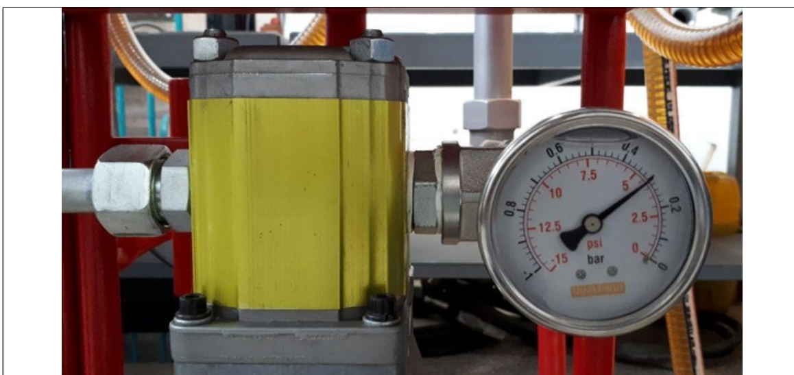
نمایش فشار مکش در ورودی پمپ بر روی گیج خلاء
